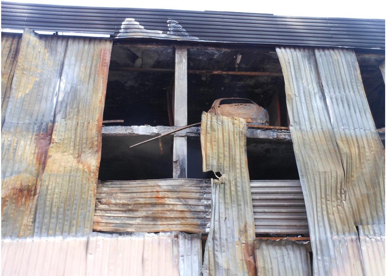
Фото 7. Фрагмент заднего фасада. Копоть и сажа на стеновом ограждении, деформации стенового ограждения в результате температурного воздействия, механические повреждения профилированного настила в результате тушения пожара на заднем фасаде в осях Г/12-23 на всю высоту здания
