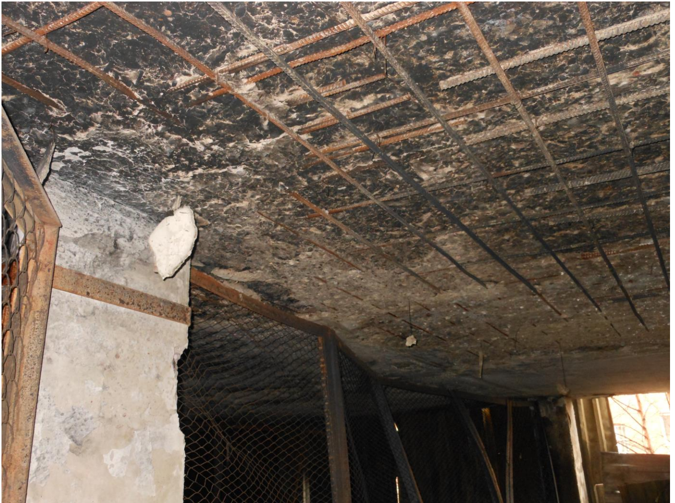
Фото 14. Фрагмент потолка 1-го этажа. Копоть и сажа на потолке и на металлическом ограждении боксов, отслоение защитного слоя бетона плиты перекрытия в осях В-Г/14-15, оголение арматуры плиты перекрытия, ржавчина на поверхности арматуры, разрушение защитного слоя бетона колонны по оси В/14
