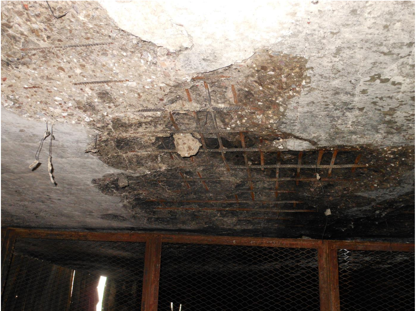
Фото 21. Фрагмент перекрытия 2-го этажа. Отслоение защитного слоя бетона плиты перекрытия в осях В-Г/13-21, оголение арматуры плиты перекрытия, ржавчина на поверхности арматуры
