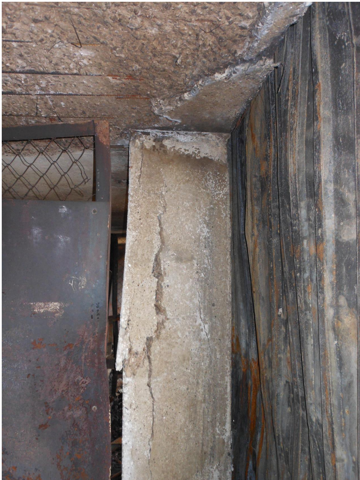
Фото 25. Разрушение колонны 2 этажа по оси Г
