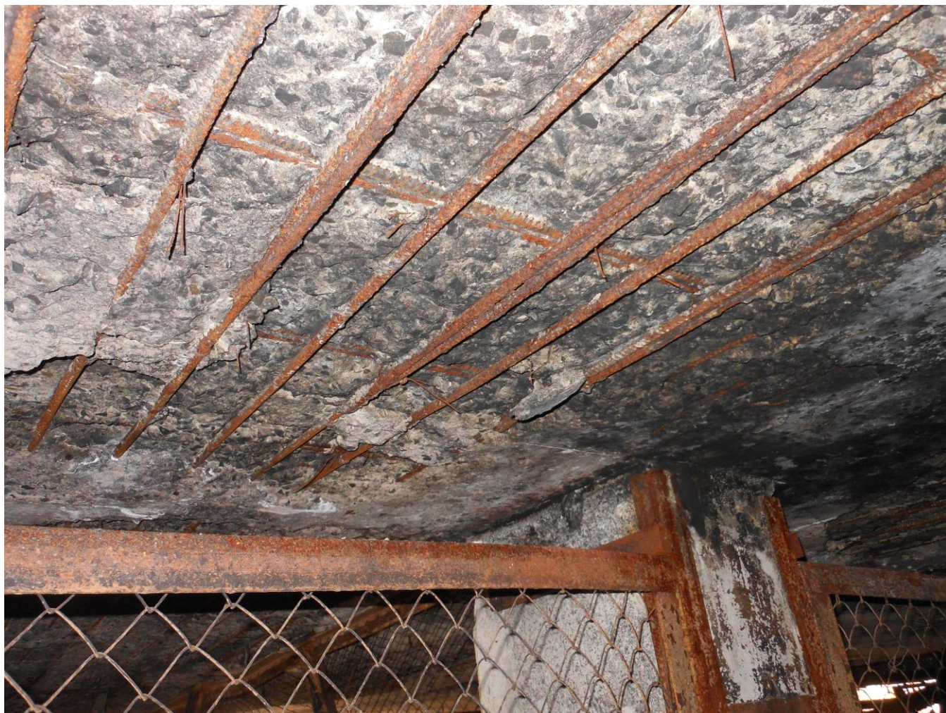
Фото 35. Фрагмент перекрытия 3-го этажа. Отслоение защитного слоя бетона плиты перекрытия в осях В-Г/13-21, оголение арматуры плиты перекрытия, ржавчина на поверхности арматуры
