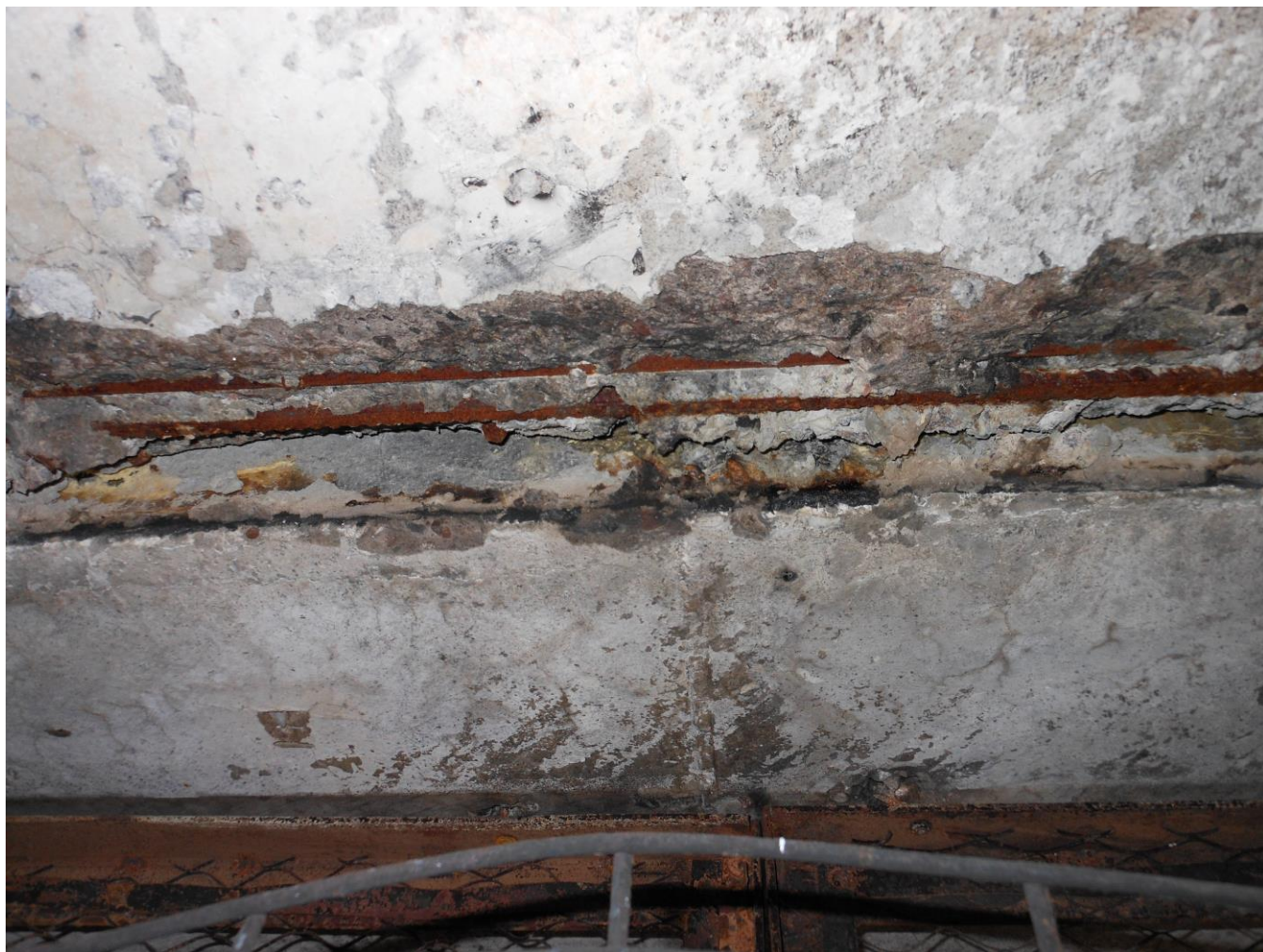
Фото 38. Фрагмент перекрытия 3-го этажа – деформационный шов. Отслоение защитного слоя бетона плиты перекрытия, оголение арматуры плиты перекрытия, ржавчина на поверхности арматуры
