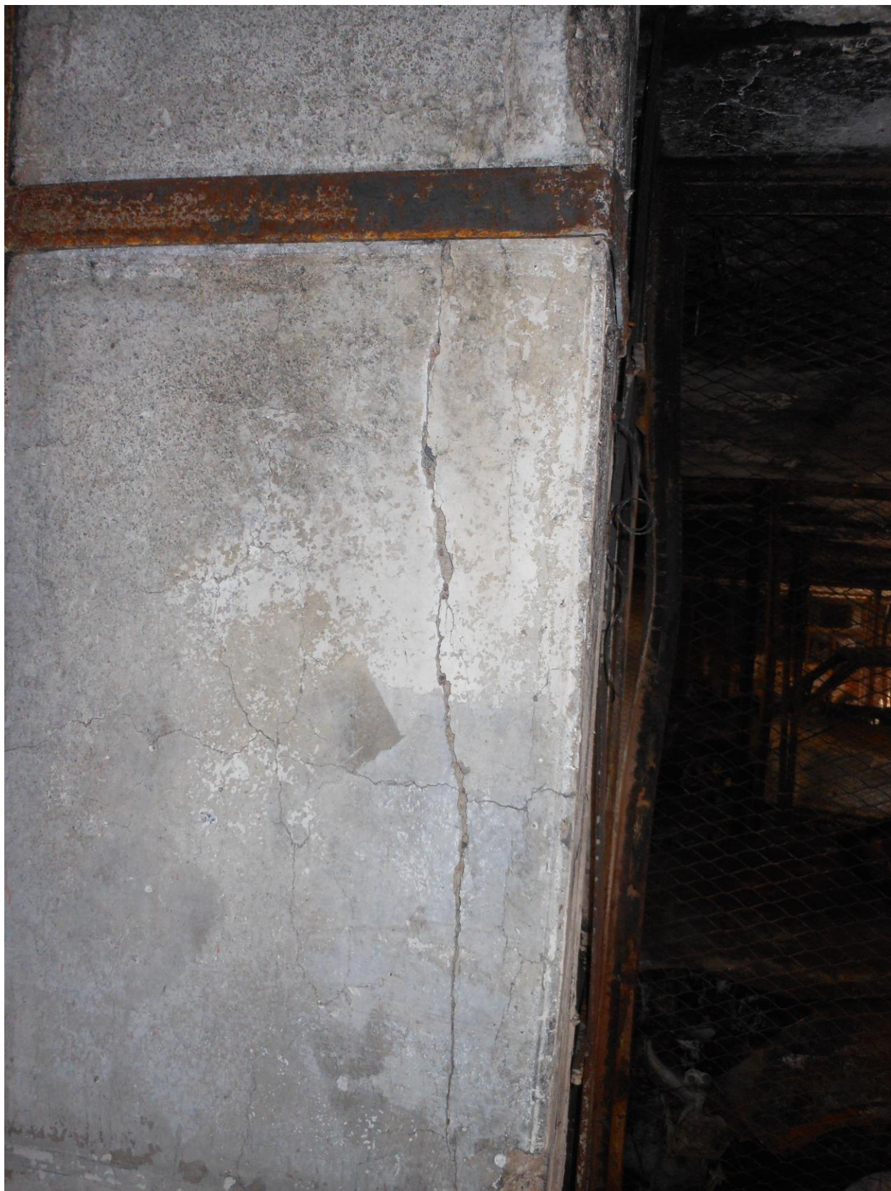
Фото 39. Трещина в колонне от температурного расширения в следствии пожара
