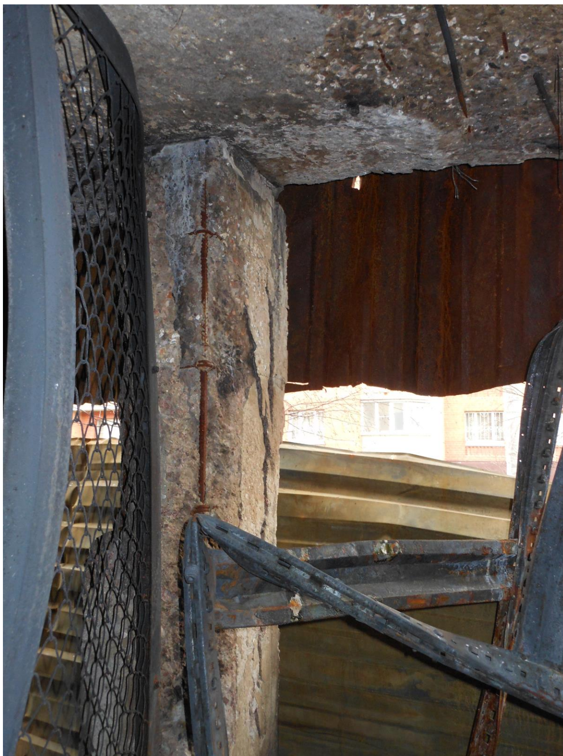
Фото 20. Фрагмент 2-го этажа. Отслоение защитного слоя бетона плиты перекрытия в осях В-Г/13-21, оголение арматуры плиты перекрытия, ржавчина на поверхности арматуры. Деформация металлического ограждения боксов, деформация наружного ограждения. Разрушение защитного слоя бетона колонны с оголением арматуры
