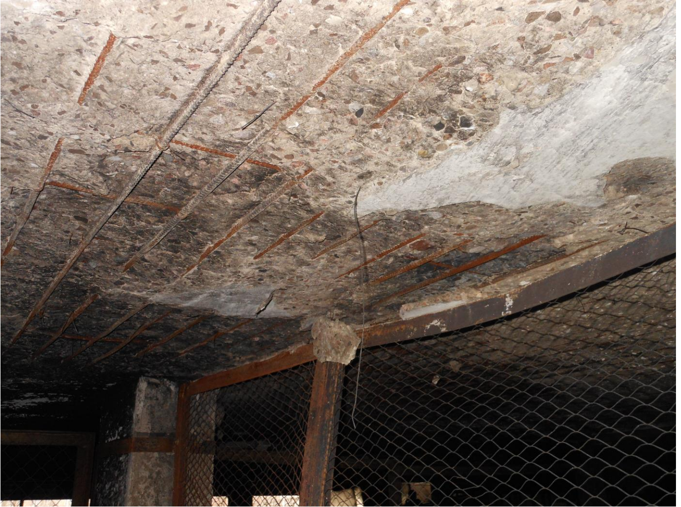
Фото 19. Фрагмент потолка 2-го этажа. Отслоение защитного слоя бетона плиты перекрытия в осях В-Г/13-21, оголение арматуры плиты перекрытия, ржавчина на поверхности арматуры. Деформация металлического ограждения боксов
