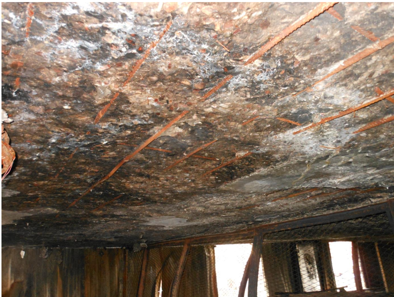
Фото 33. Фрагмент перекрытия 3-го этажа. Отслоение защитного слоя бетона плиты перекрытия в осях В-Г/13-21, оголение арматуры плиты перекрытия, ржавчина на поверхности арматуры
