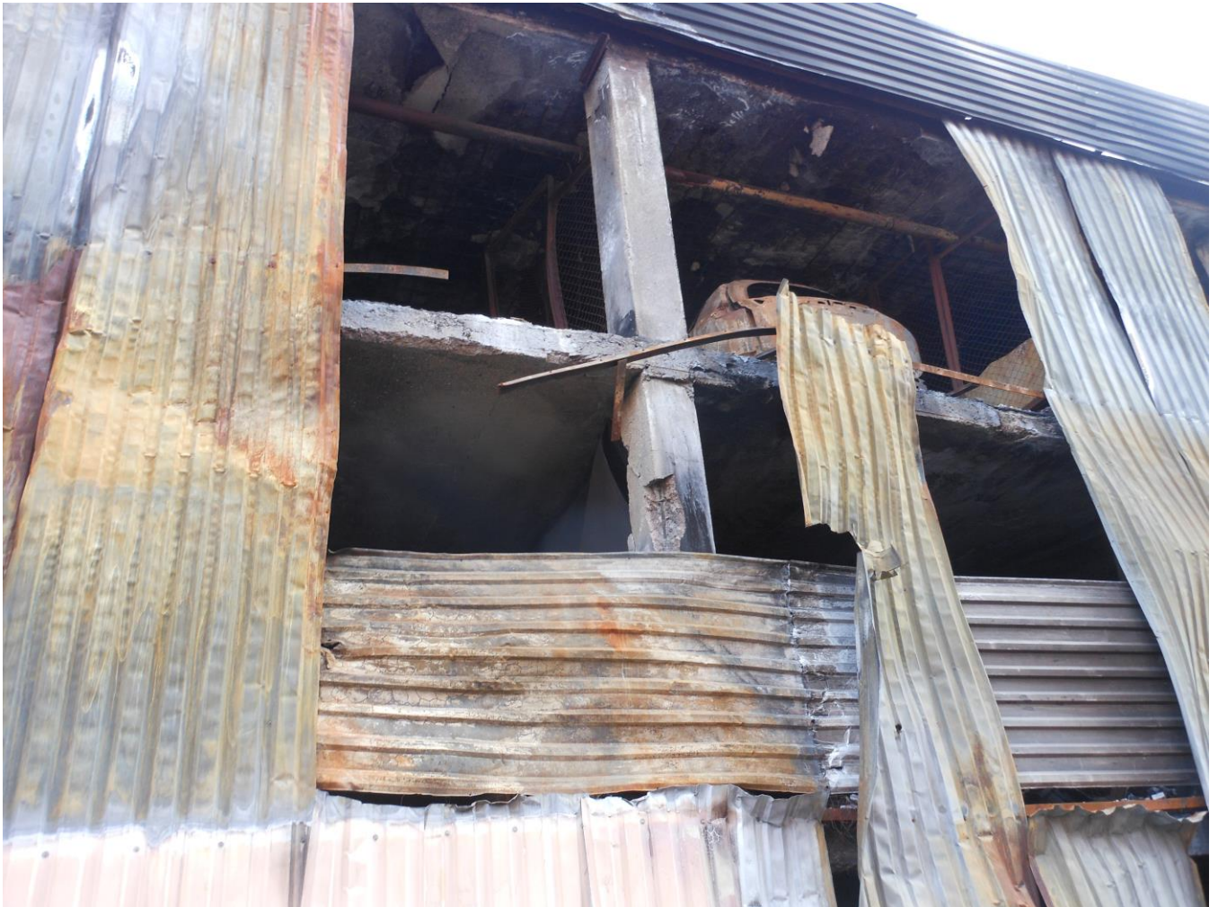
Фото 9. Фрагмент заднего фасада. Копоть и сажа на стеновом ограждении, деформации стенового ограждения в результате температурного воздействия, механические повреждения профилированного настила в результате тушения пожара на заднем фасаде в осях Г/12-23 на всю высоту здания. Разрушение защитного слоя бетона колонны до арматуры, отслоение пластов бетона на торцах плиты перекрытия
