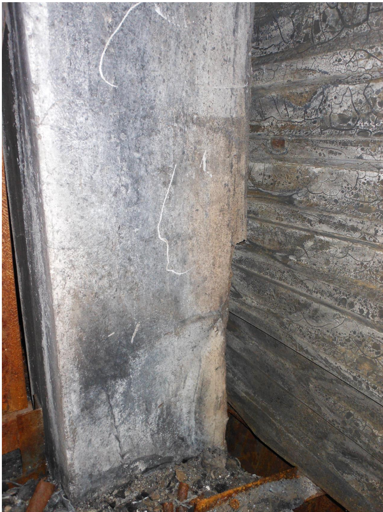
Фото 31. Разрушение защитного слоя бетона колонны 3 этажа по оси Г
