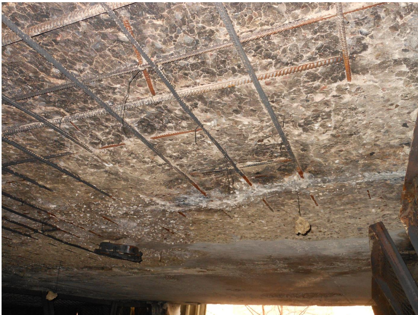
Фото 15. Фрагмент потолка 1-го этажа. Отслоение защитного слоя бетона плиты перекрытия в осях В-Г/14-15, оголение арматуры плиты перекрытия, ржавчина на поверхности арматуры
