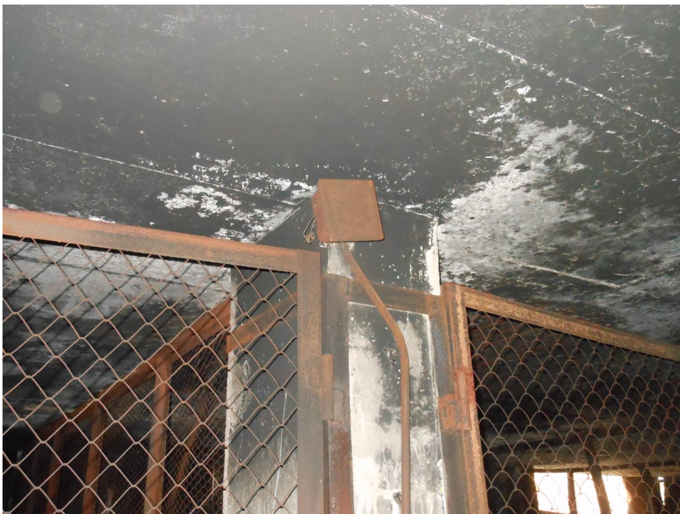
Фото 12. Фрагмент потолка 1-го этажа. Копоть и сажа на потолке и на металлическом ограждении боксов
