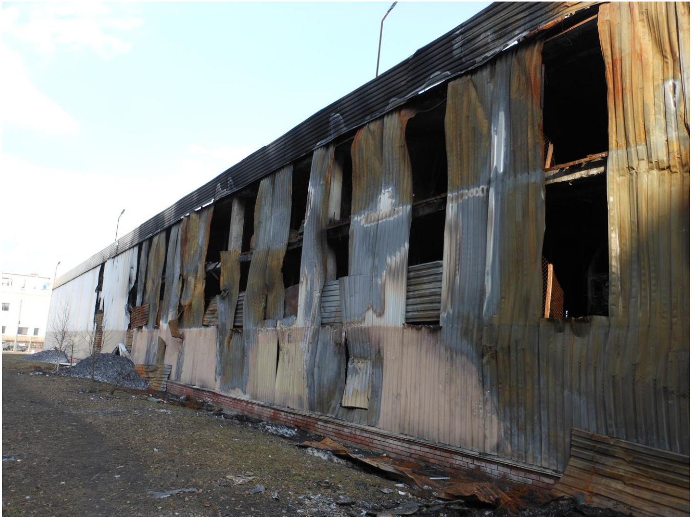
Фото 8. Фрагмент заднего фасада. Копоть и сажа на стеновом ограждении, деформации стенового ограждения в результате температурного воздействия, механические повреждения профилированного настила в результате тушения пожара на заднем фасаде в осях Г/12-23 на всю высоту здания
