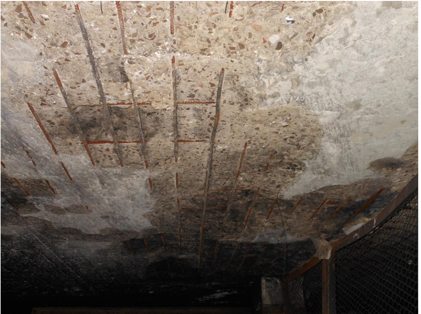
Фото 22. Фрагмент перекрытия 2-го этажа. Отслоение защитного слоя бетона плиты перекрытия в осях В-Г/13-21, оголение арматуры плиты перекрытия, ржавчина на поверхности арматуры
