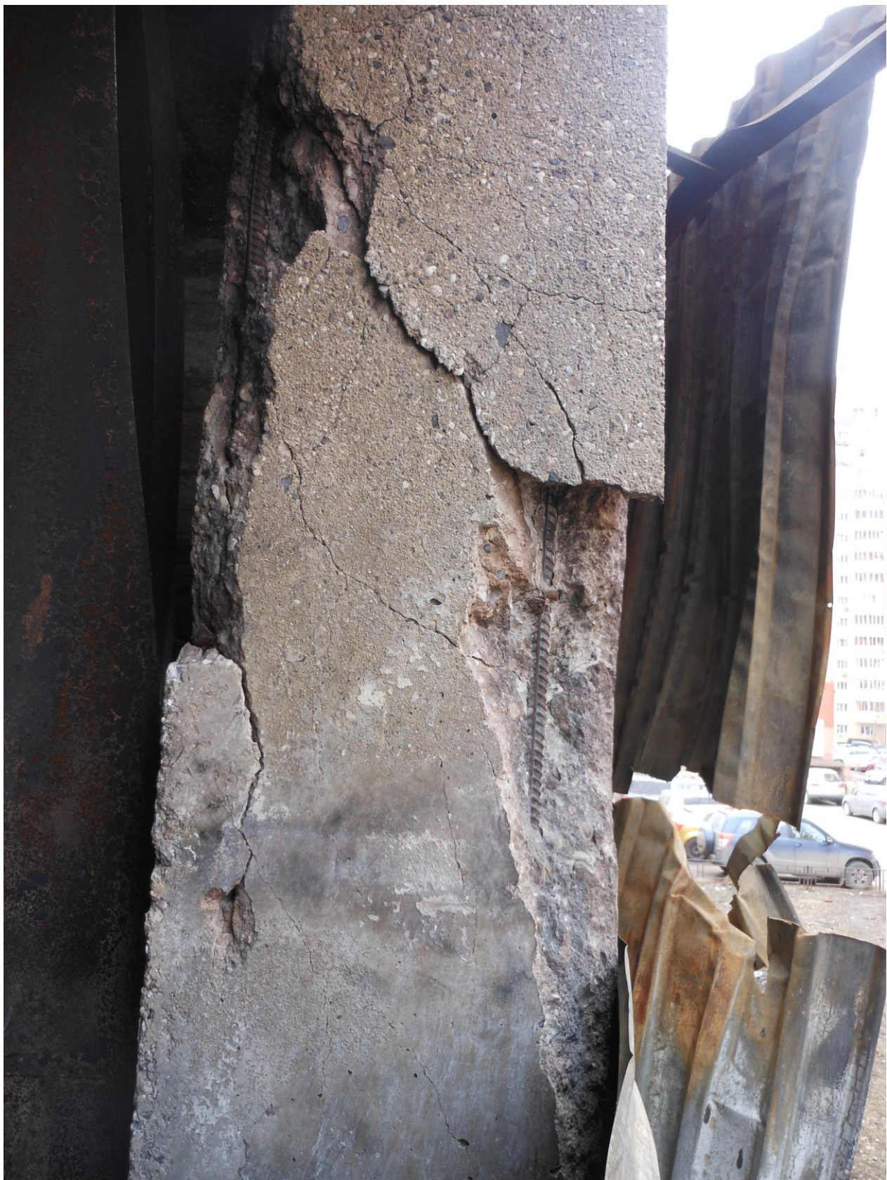
Фото 28. Разрушение колонны 2 этажа по оси Г. Оголение арматуры
