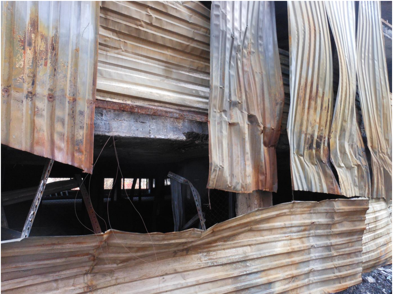
Фото 10. Фрагмент заднего фасада. Деформации стенового ограждения в результате температурного воздействия на заднем фасаде в осях Г/12-23. Разрушение защитного слоя бетона плиты перекрытия до арматуры
