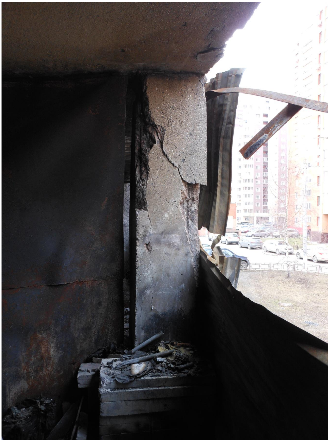
Фото 27. Разрушение колонны 2 этажа по оси Г. Оголение арматуры
