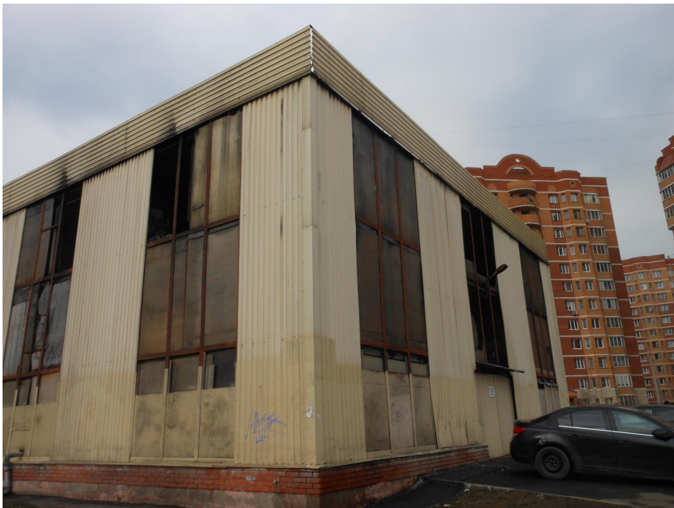
Фото 2. Торцевой фасад. Копоть и сажа на стеновом ограждении
