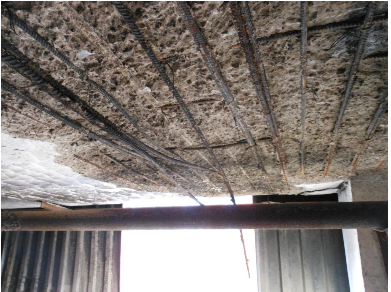
Фото 42. Фрагмент перекрытия 3-го этажа. Отслоение защитного слоя бетона плиты перекрытия, оголение арматуры плиты перекрытия, провисание арматуры, ржавчина на поверхности арматуры
