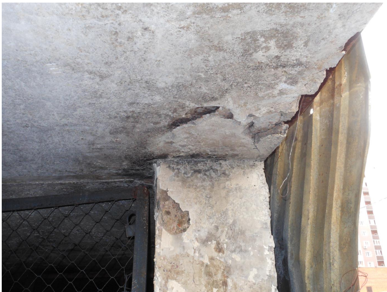
Фото 16. Фрагмент потолка 1-го этажа. Отслоение защитного слоя бетона плиты перекрытия в осях В-Г/15-16, разрушение защитного слоя бетона колонны в осях 15/Г
