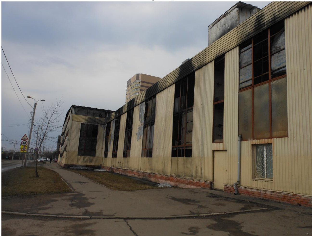
Фото 1. Главный фасад. Копоть и сажа на стеновом ограждении
