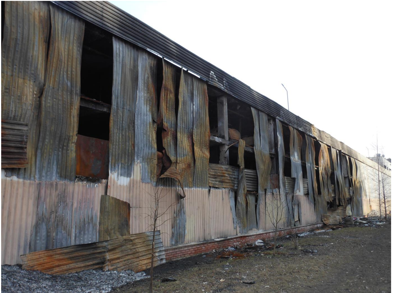
Фото 6. Фрагмент заднего фасада. Копоть и сажа на стеновом ограждении, деформации стенового ограждения в результате температурного воздействия, механические повреждения профилированного настила в результате тушения пожара на заднем фасаде в осях Г/12–23 на всю высоту здания
