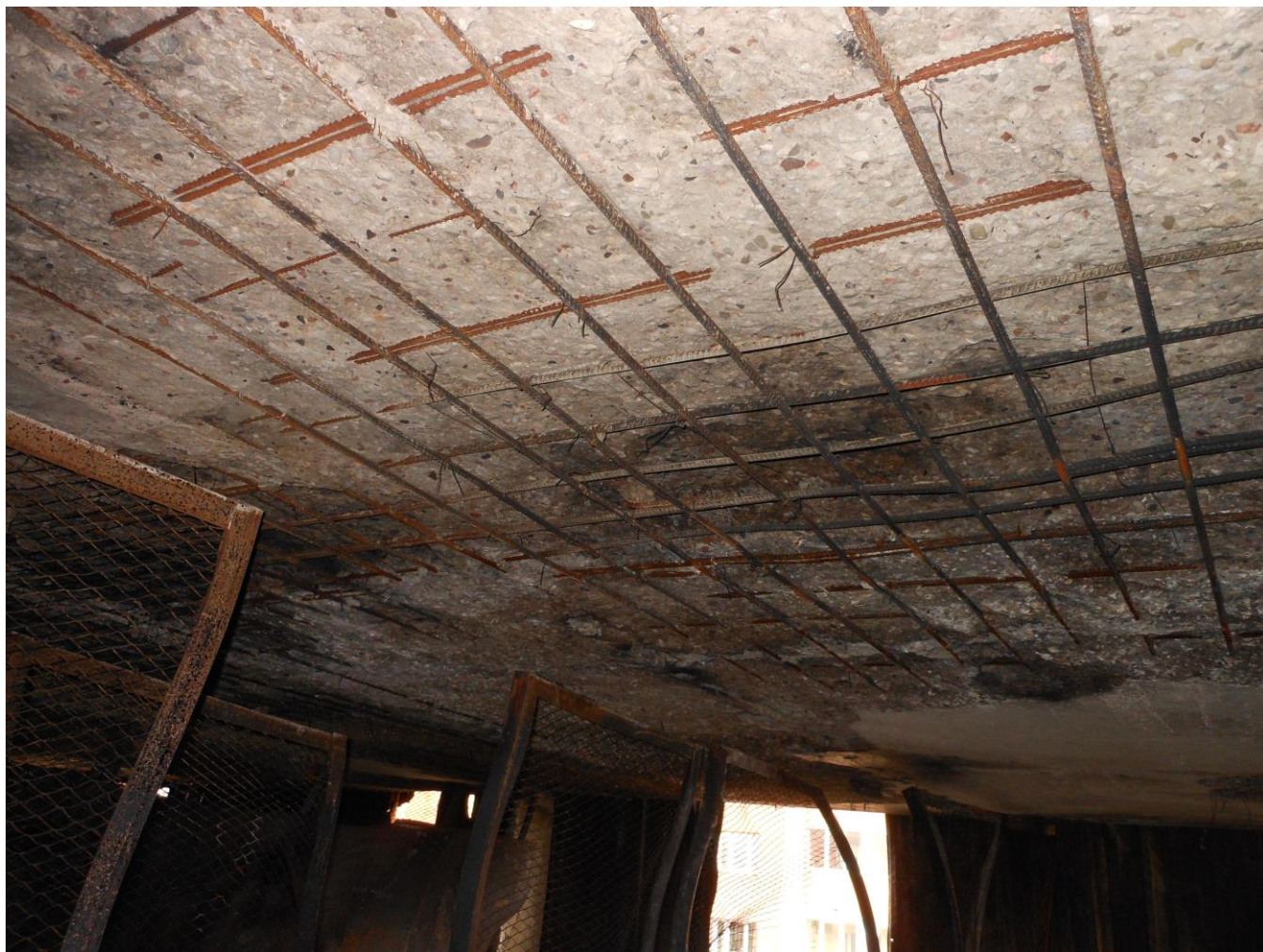
Фото 24. Фрагмент перекрытия 2-го этажа. Отслоение защитного слоя бетона плиты перекрытия в осях В-Г/13-21, оголение арматуры плиты перекрытия, ржавчина на поверхности арматуры
