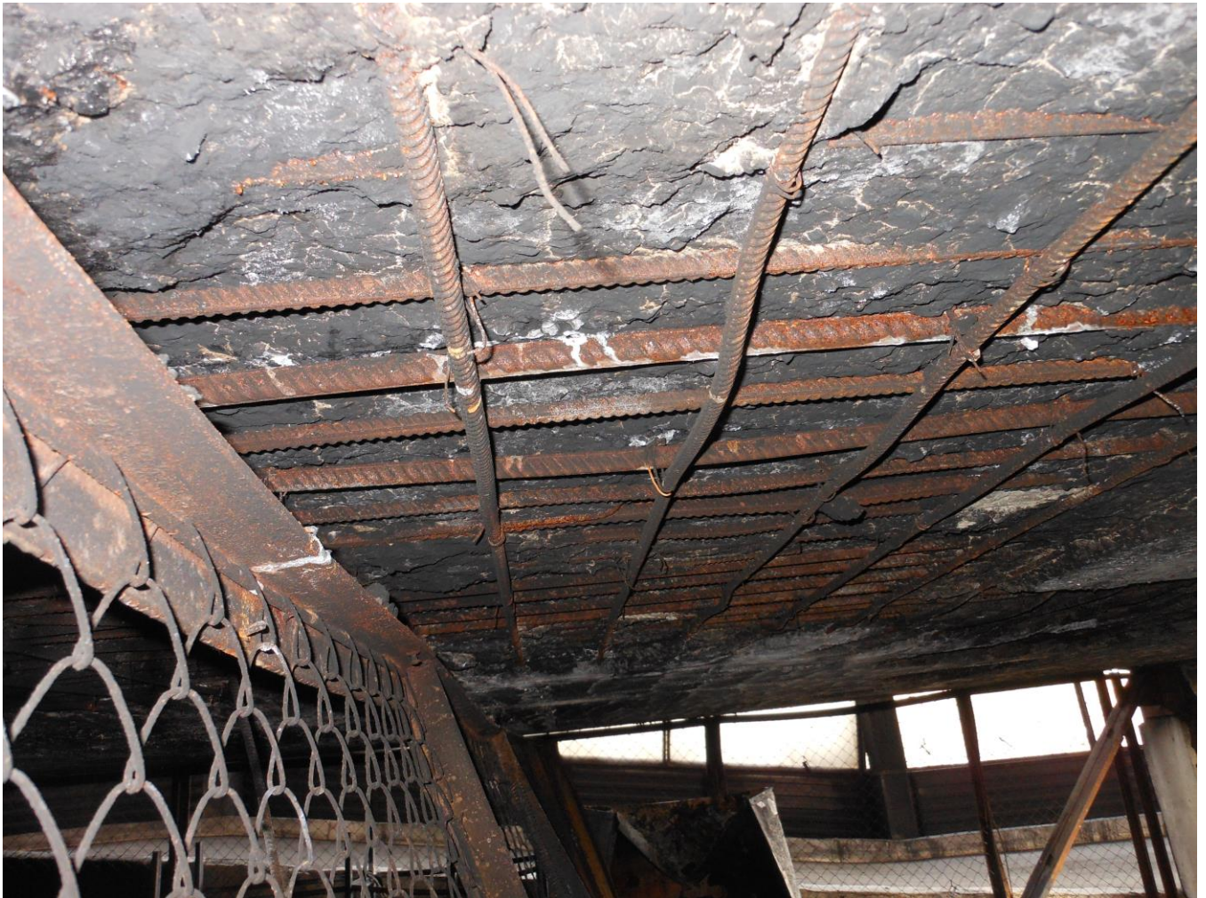
Фото 34. Фрагмент перекрытия 3-го этажа. Отслоение защитного слоя бетона плиты перекрытия в осях В-Г/13-21, оголение арматуры плиты перекрытия, ржавчина на поверхности арматуры
