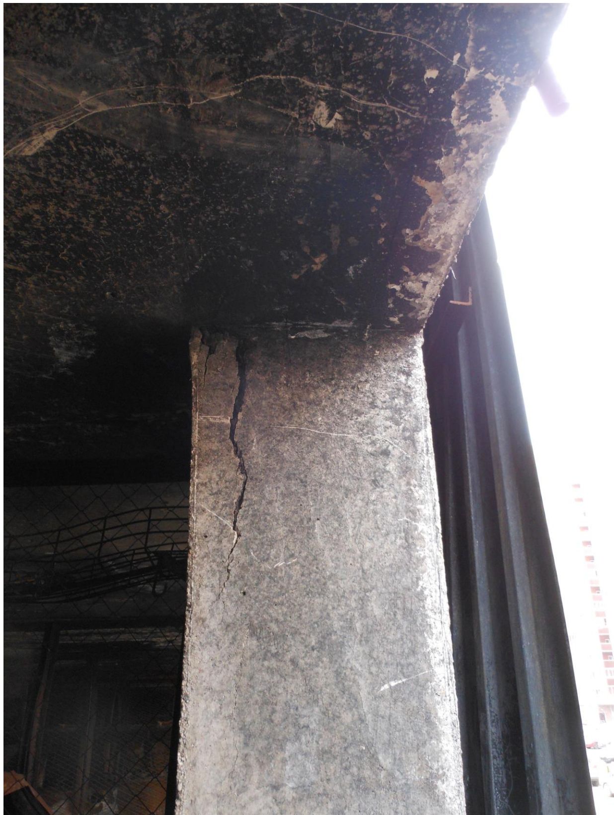
Фото 29. Разрушение защитного слоя бетона колонны 3 этажа по оси Г
