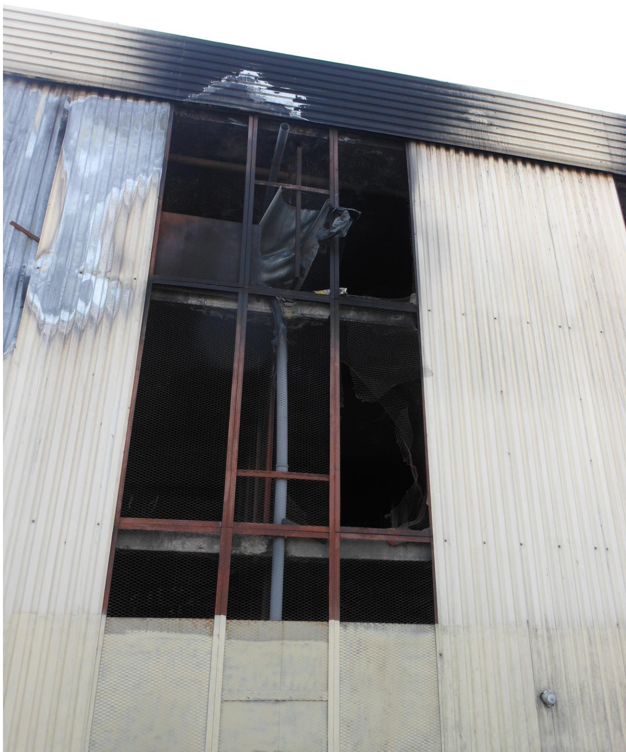
Фото 3. Фрагмент главного фасада. Копоть и сажа на стеновом ограждении
