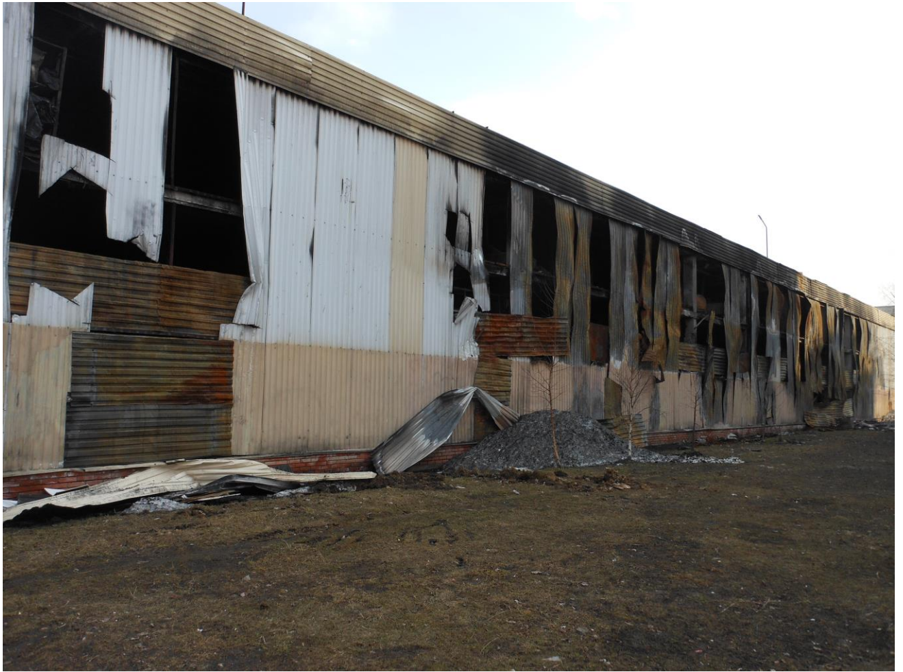
Фото 5. Фрагмент заднего фасада. Копоть и сажа на стеновом ограждении, деформации стенового ограждения в результате температурного воздействия, механические повреждения профилированного настила в результате тушения пожара на заднем фасаде в осях Г/12-23 на всю высоту здания
