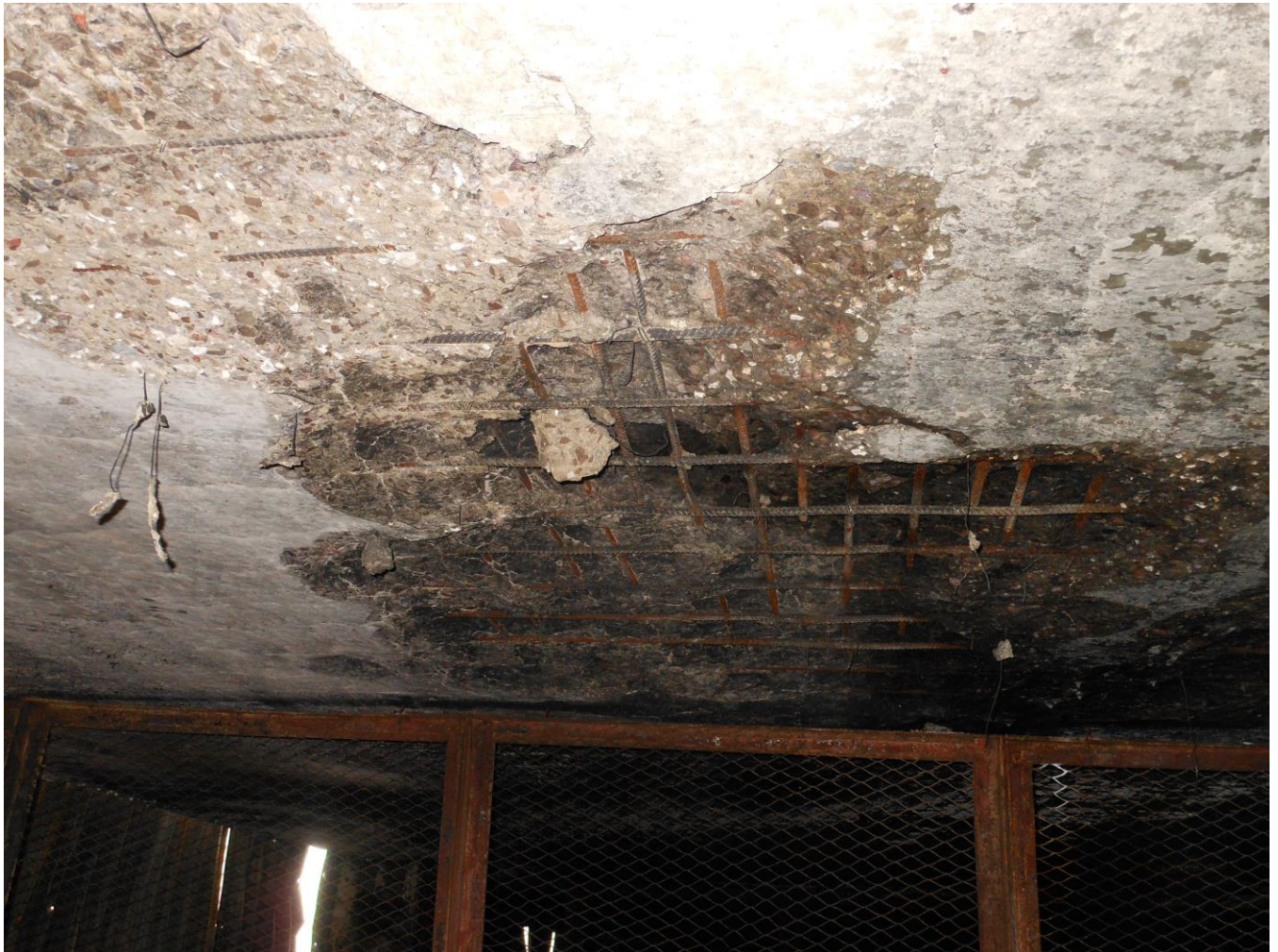
Фото 18. Фрагмент потолка 2-го этажа. Отслоение защитного слоя бетона плиты перекрытия в осях В-Г/13-21, оголение арматуры плиты перекрытия, ржавчина на поверхности арматуры
