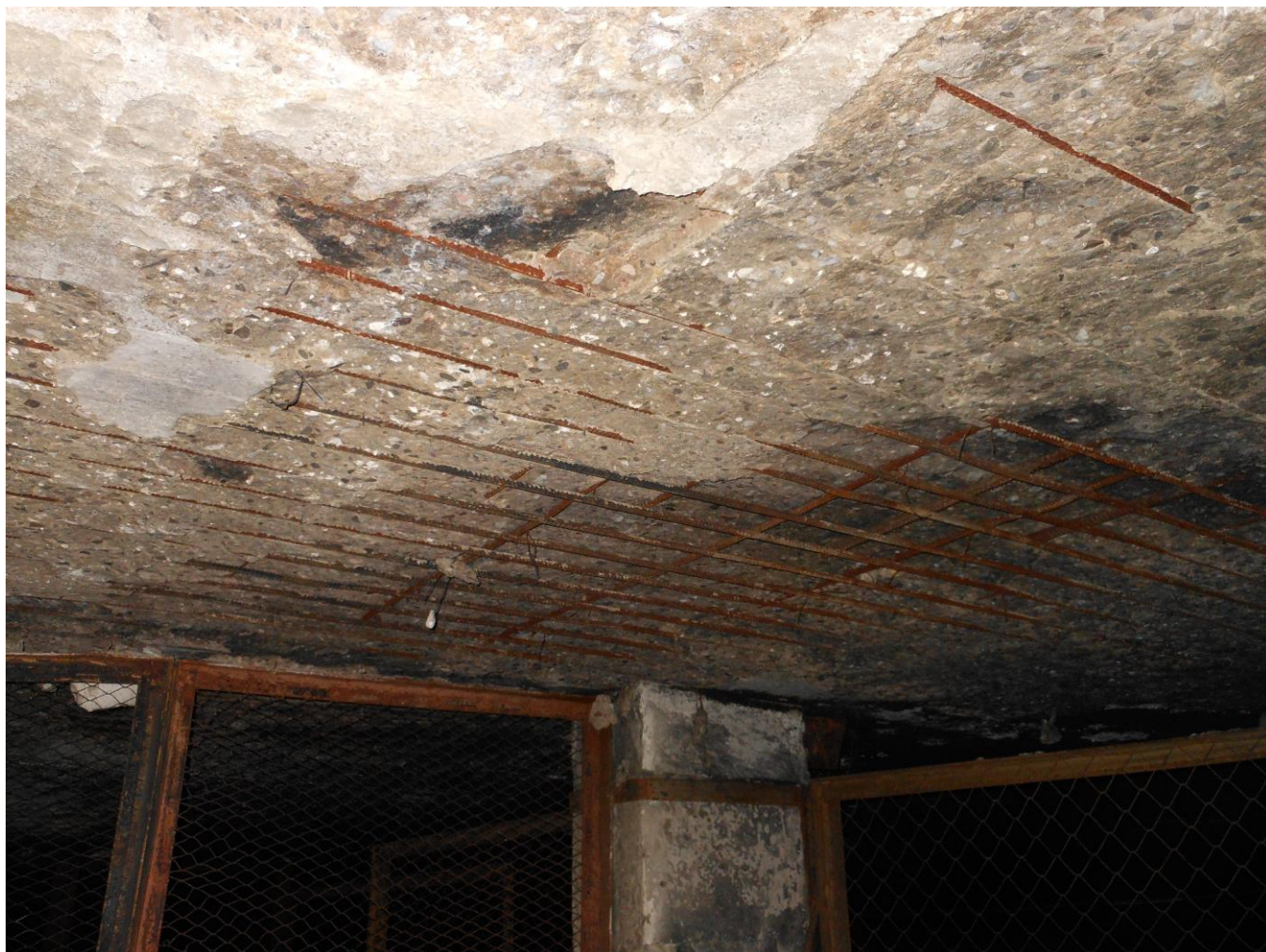
Фото 17. Фрагмент потолка 2-го этажа. Отслоение защитного слоя бетона плиты перекрытия в осях В-Г/13-21, оголение арматуры плиты перекрытия, ржавчина на поверхности арматуры
