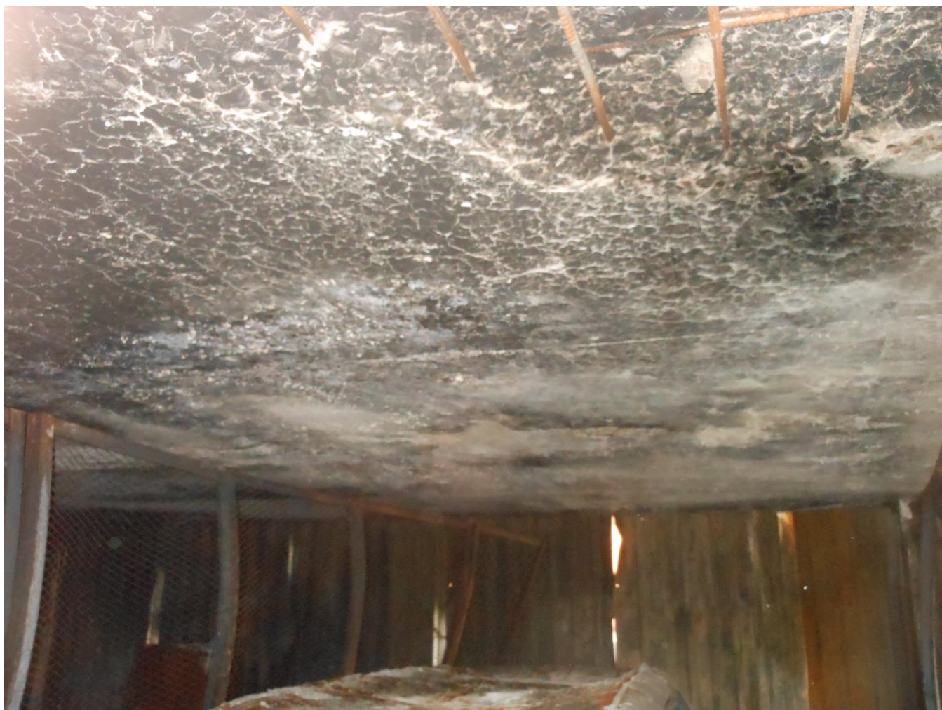
Фото 13. Фрагмент потолка 1-го этажа. Копоть и сажа на потолке и на металлическом ограждении боксов, отслоение защитного слоя бетона плиты перекрытия, оголение арматуры плиты перекрытия, ржавчина на поверхности арматуры
