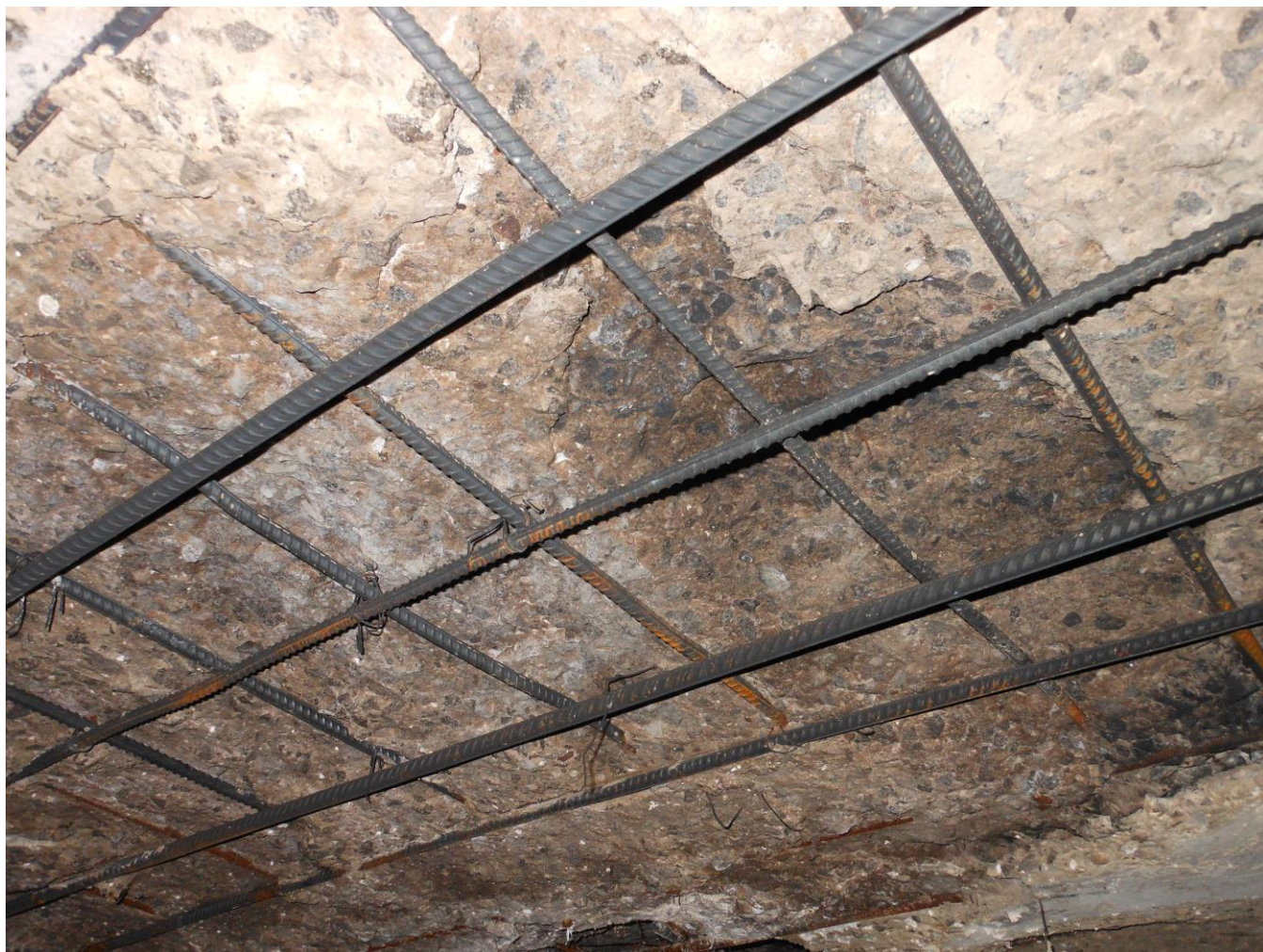
Фото 40. Фрагмент перекрытия 3-го этажа. Отслоение защитного слоя бетона плиты перекрытия на глубину больше защитного слоя бетона, оголение арматуры плиты перекрытия, ржавчина на поверхности арматуры
