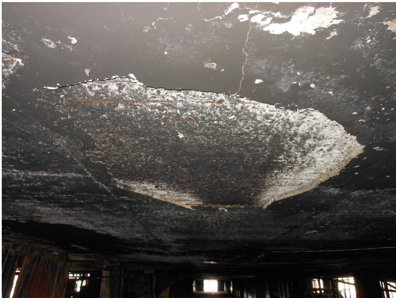
Фото 36. Фрагмент перекрытия 3-го этажа. Отслоение защитного слоя бетона плиты перекрытия в осях В-Г/13-21, оголение арматуры плиты перекрытия, ржавчина на поверхности арматуры. Копоть и сажа на поверхности потолка
