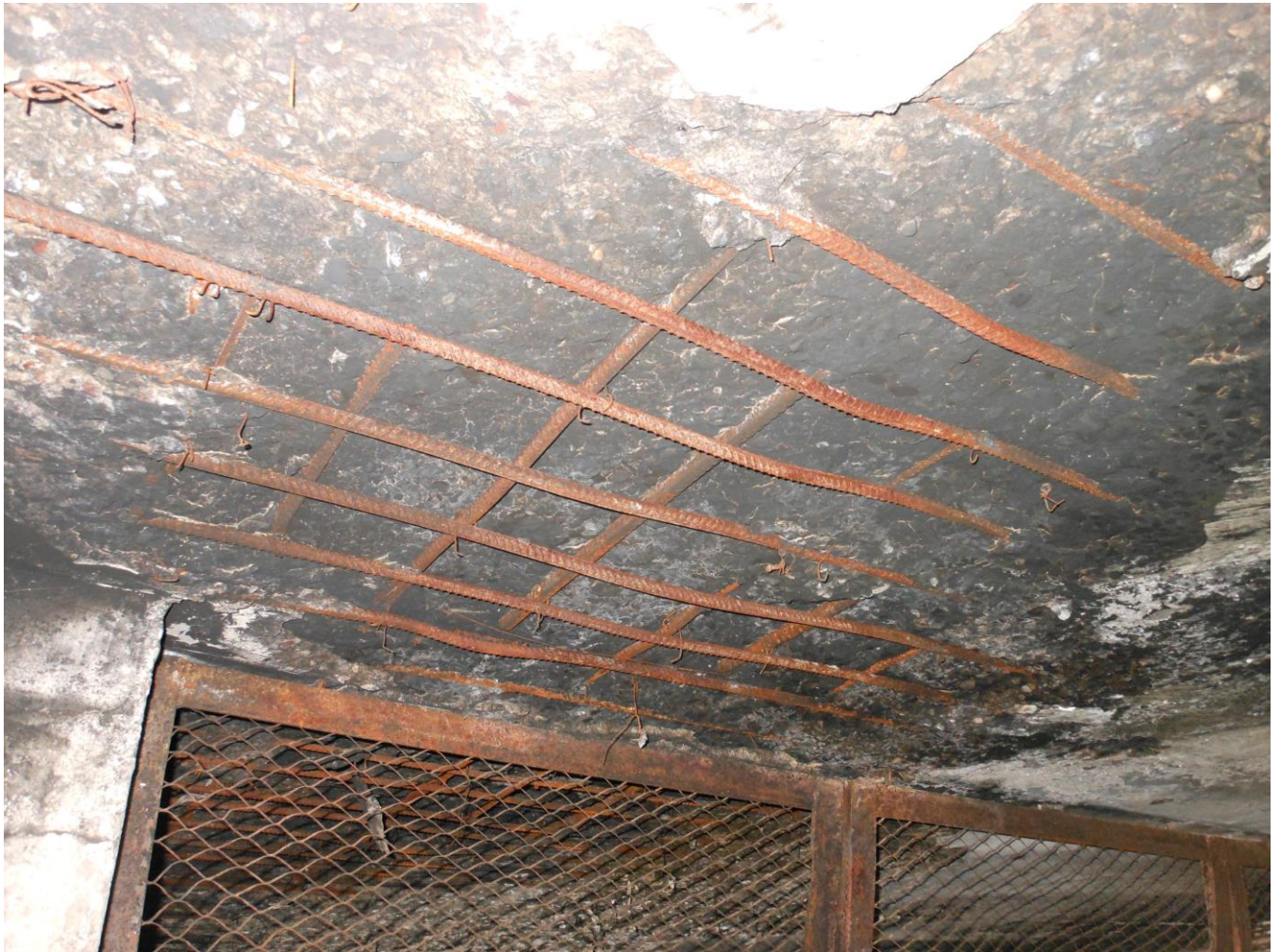
Фото 32. Фрагмент перекрытия 3-го этажа. Отслоение защитного слоя бетона плиты перекрытия в осях В-Г/13-21, оголение арматуры плиты перекрытия, ржавчина на поверхности арматуры
