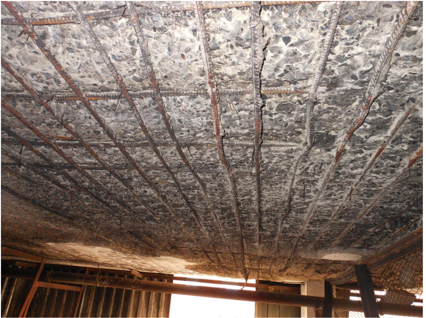
Фото 41. Фрагмент перекрытия 3-го этажа. Отслоение защитного слоя бетона плиты перекрытия, оголение арматуры плиты перекрытия, ржавчина на поверхности арматуры, деформация арматуры в результате температурного воздействия
