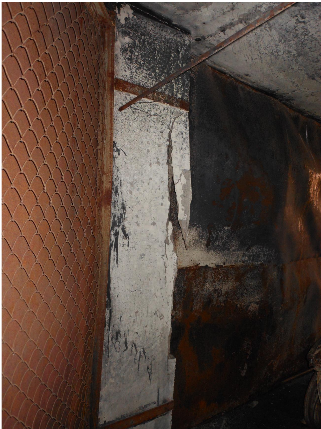
Фото 26. Разрушение колонны 2 этажа по оси Г
