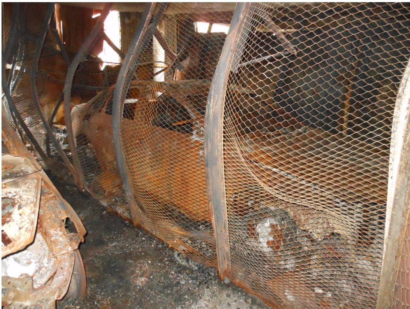
Фото 37. Деформация металлического ограждения боксов от температурного воздействия. Ржавчина на металлическом ограждении
