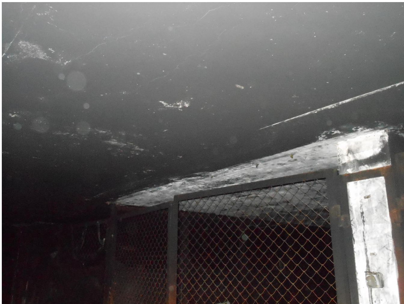
Фото 11. Фрагмент потолка 1-го этажа. Копоть и сажа на потолке и на металлическом ограждении боксов
