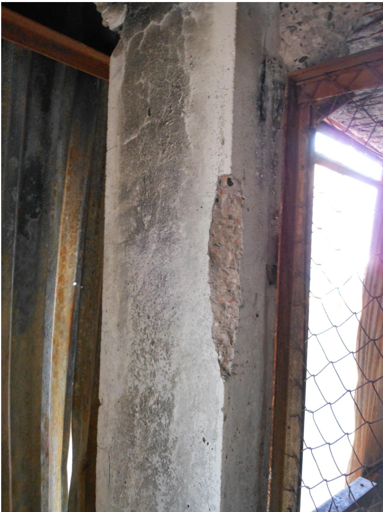
Фото 30. Разрушение защитного слоя бетона колонны 3 этажа по оси Г
