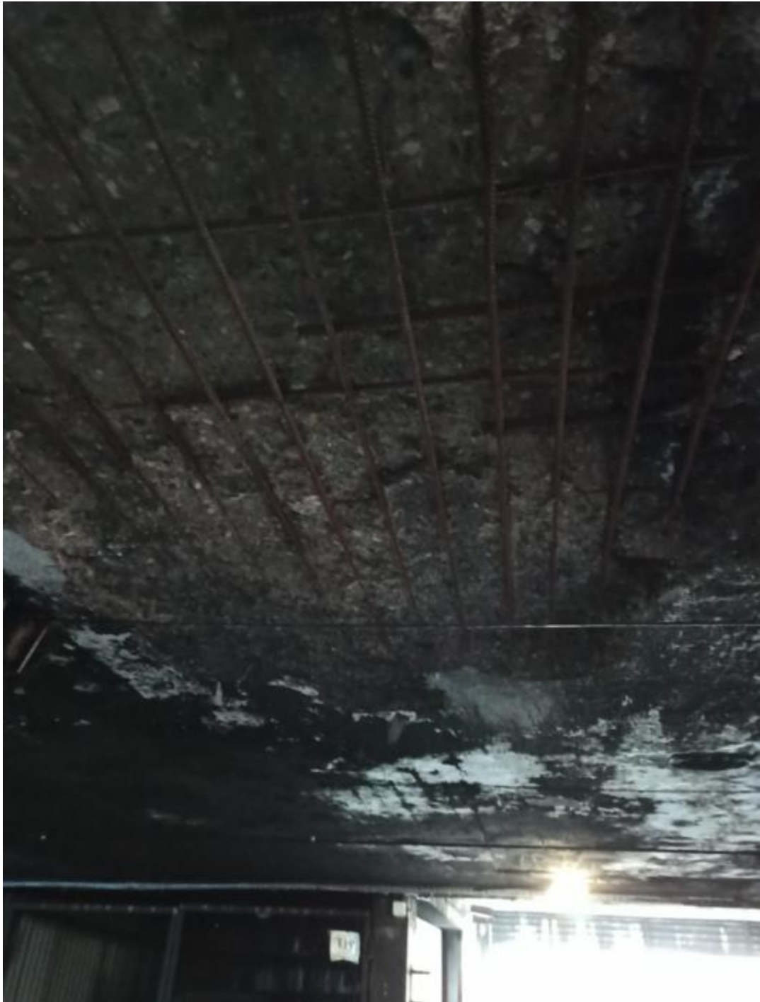
Деструктивные слои бетона, следы разрушения перекрытия.
