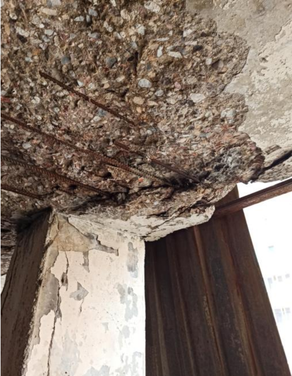
Деструктивные слои бетона, следы разрушения перекрытия и колонн.
