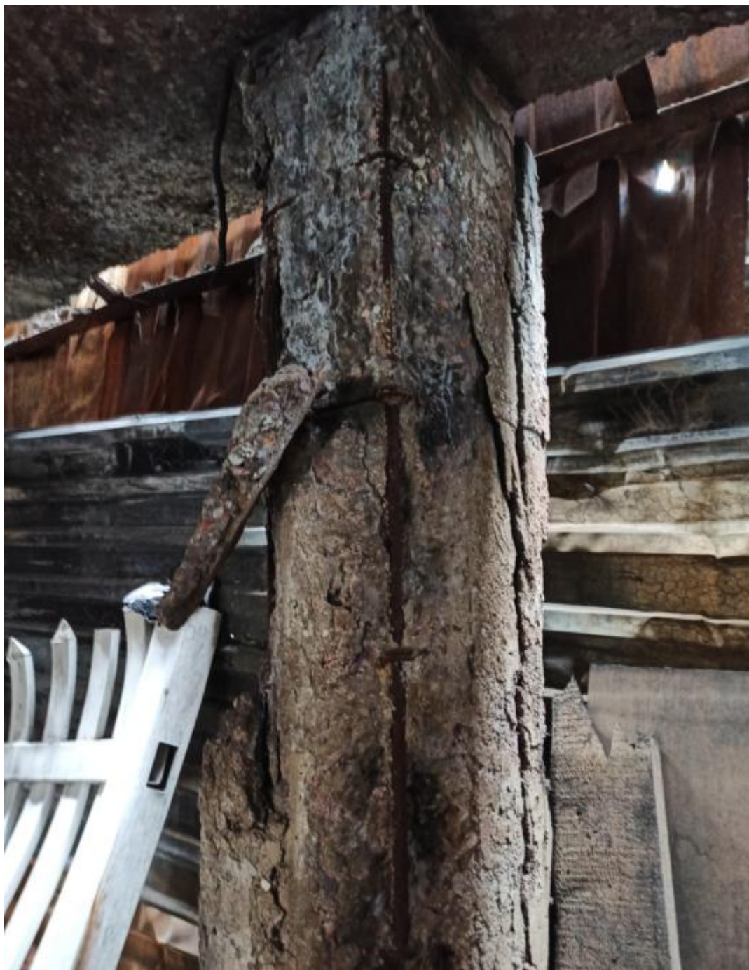
Разрушение бетона колонн.
